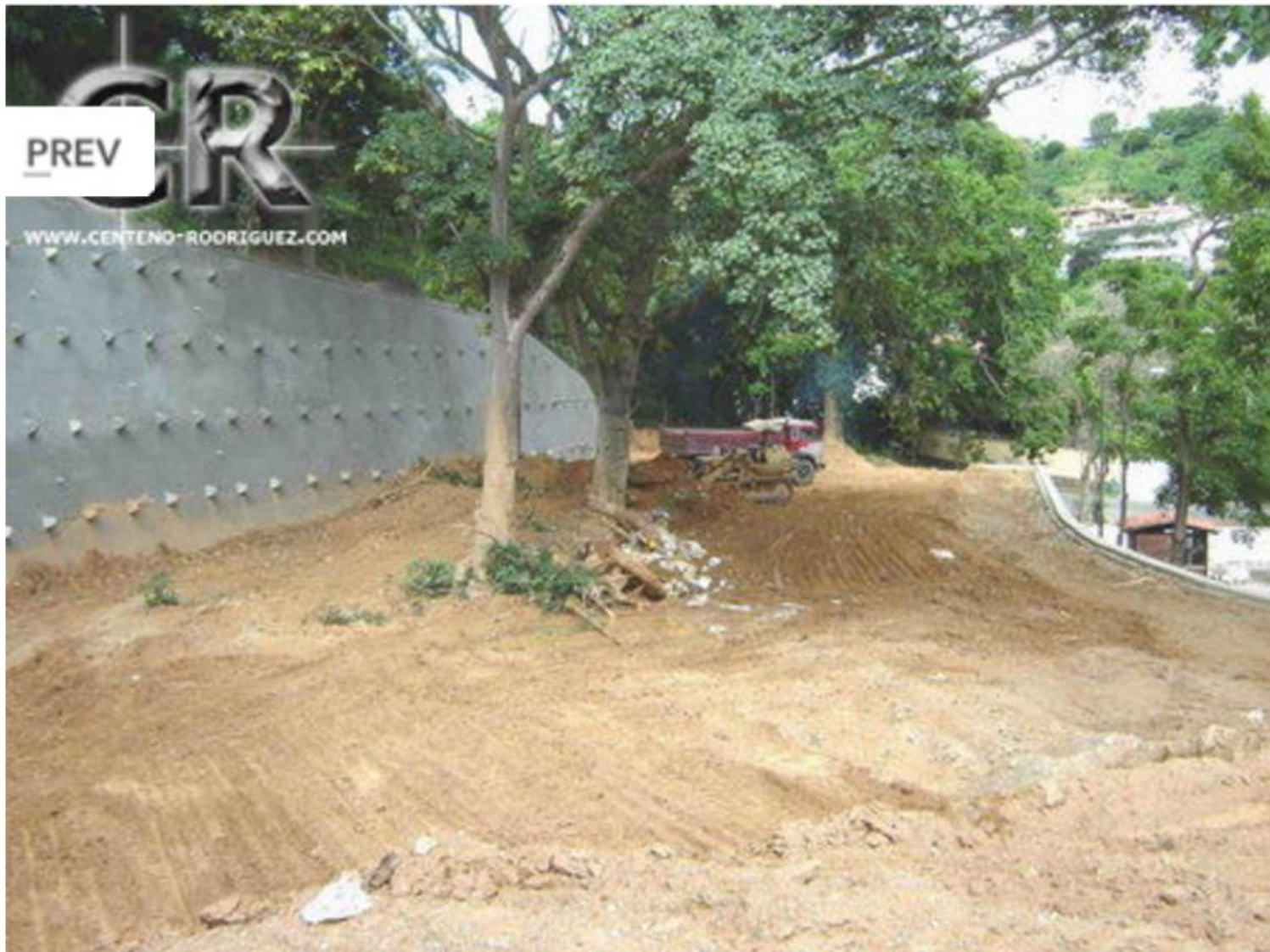
Terraza lograda gracias a Muros Mesa y una Pantalla Atirantada, Urb. Prados del Este.
