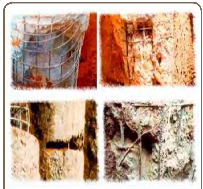
Fig. 8. Las interrupciones de la integridad del fuste, en pilotes y pilas, deben ser reparadas oportunamente si se encuentran accesibles. Representan peligro para la obra por estar dentro del elemento de fundación afectado por falta de concreto. Barras expuestas se corroen en el tiempo.
