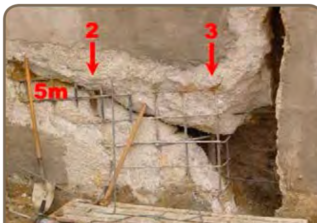
Fig. 11. Ejemplo de una interrupción muy importante en una pila de gran capacidad de un muro perimetral. Profundidad a 5 metros desde la superficie. Desplazamiento de la armadura.
